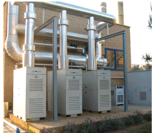
Depuradora de Rubí (Barcelona) 3 CR65 con tratamiento de combustible
