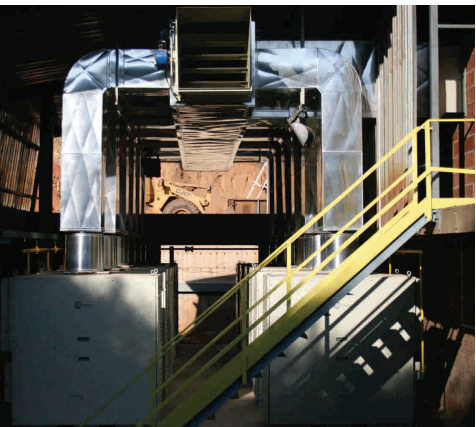
Cerámicas La Corona. Canovelles (Barcelona) 12 microturbinas C65 para el secado de ladrillos
